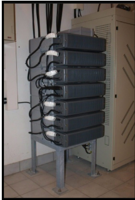
Figure 23 : BTS Flexi indoor (BTS logé dans un local Technique)
