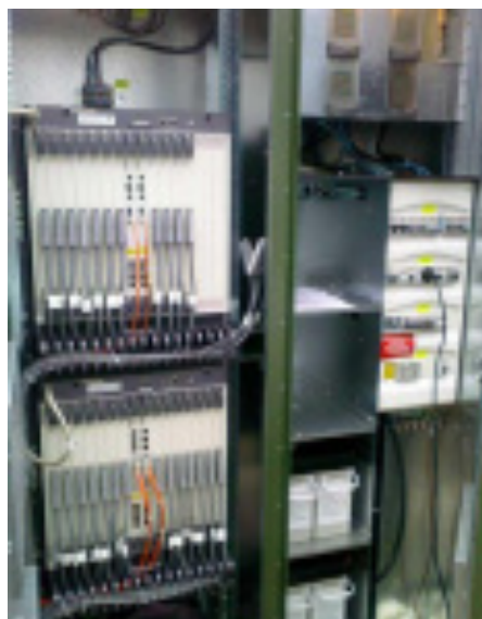
Figure 2 : DSLAM Alcatel de Tunisie Telecom
