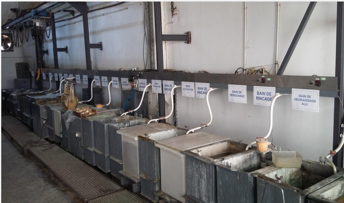
Figure : atelier traitement de surface
