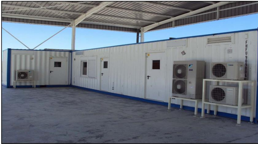
Figure 1.2 : unité des gaz spéciaux installée à l'usine de Borj Cedria
